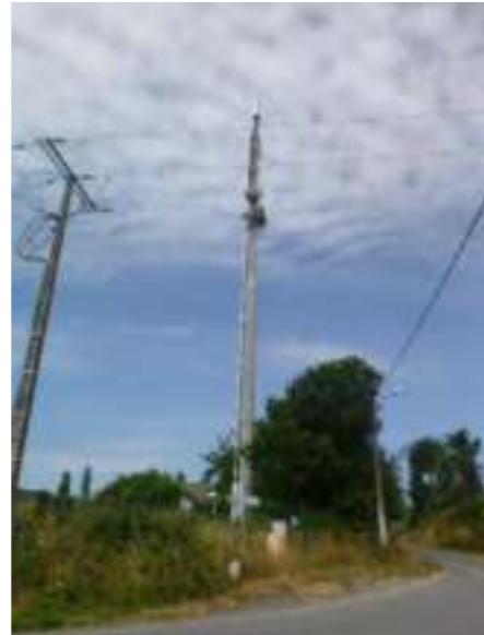
Photographie 31 : Pylône de l'opérateur Free en sortie sud-ouest du bourg de Corlay (Source : ENCIS Environnement)
